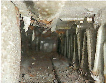
Erhöhter Aufwand: Auch in diesem Schweller blättert der Rost schon ab
