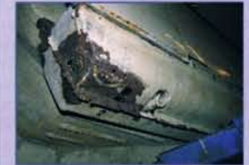
Doch unter dem Bitumenanstrich lauert das braune Grauen
