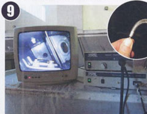
9 Für die Analyse der Hohlräume benutzt der Fachmann ein flexibles Endoskop mit extrem hoher Lichtleistung – die schadhaften Stellen werden via Monitor angezeigt.
